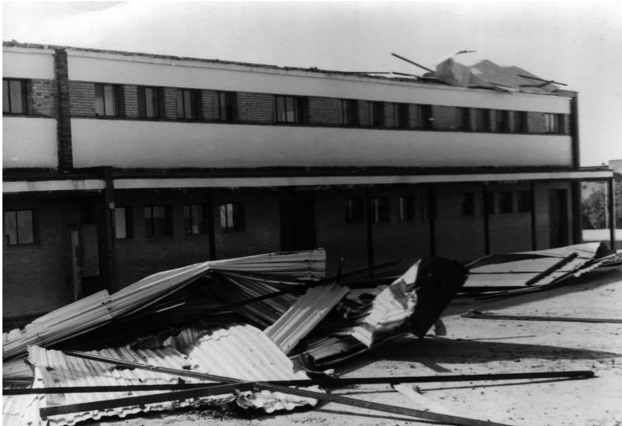
Colegio en 1974. Estas fotos se hicieron porque un vendaval terrible asoló el pueblo y se llevó la estructura nueva de los voladizos de los techos.
